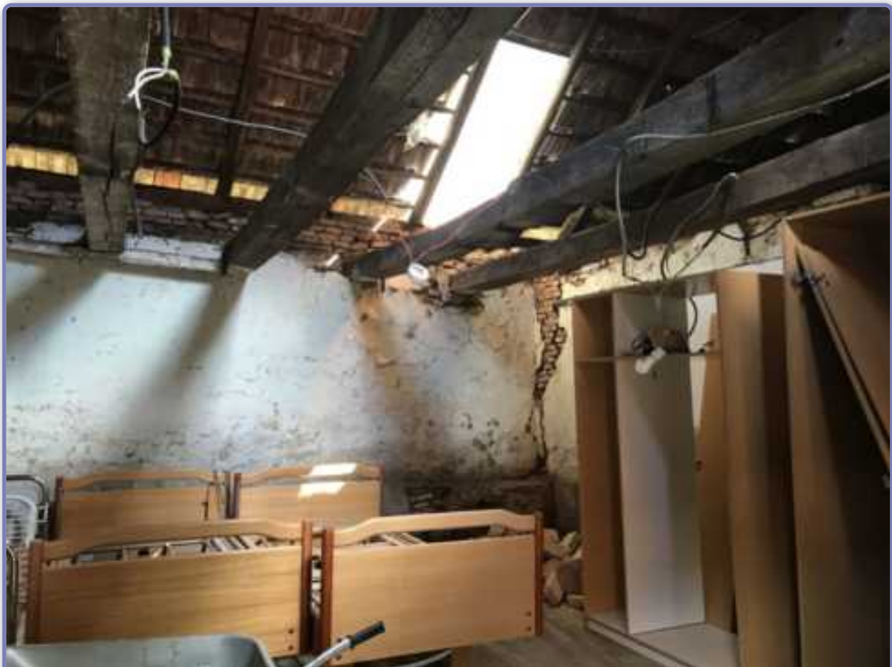
Hetzeldorf 2025 – im Lagerraum regnet es durch, das Dach muss unbedingt erneuert werden.
